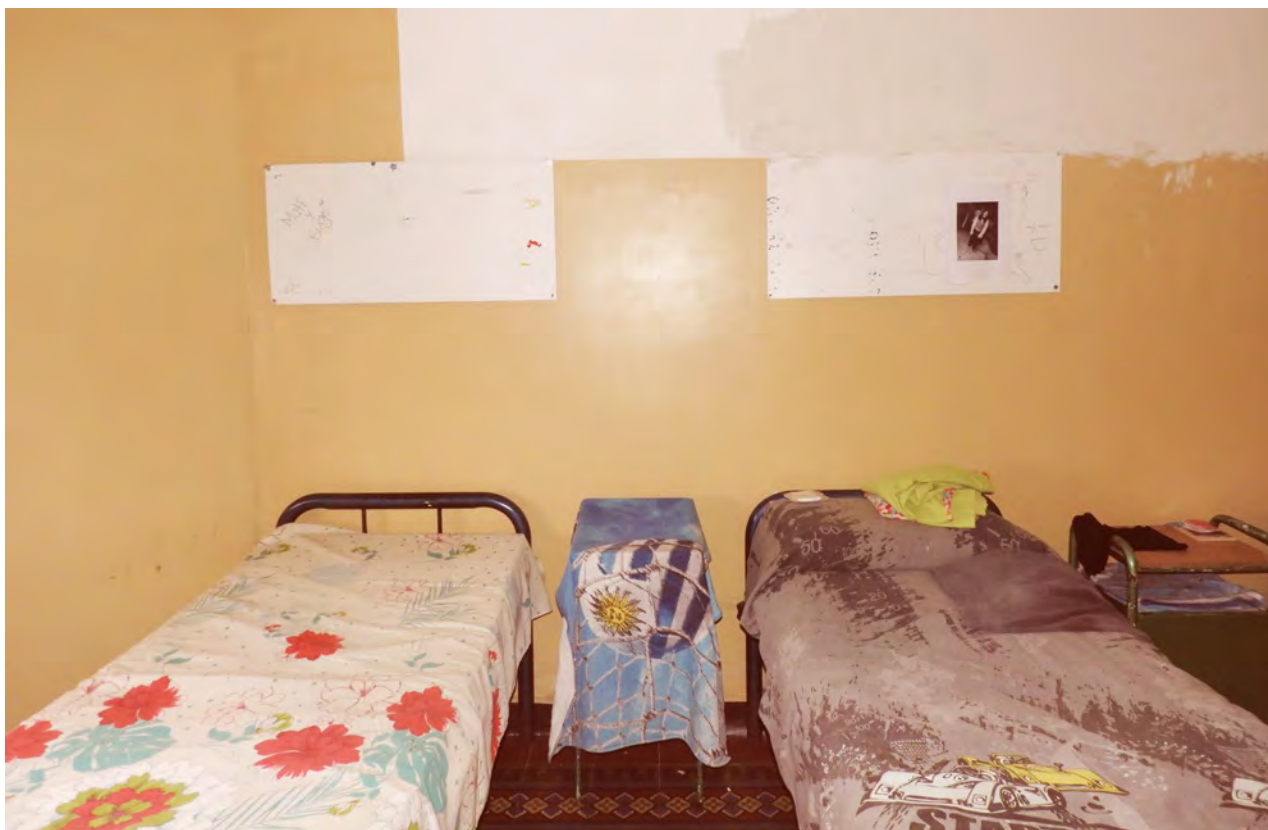
Foto 12. Habitación con falta de mantenimiento. Centro de atención en salud mental a trastornos compensados.
